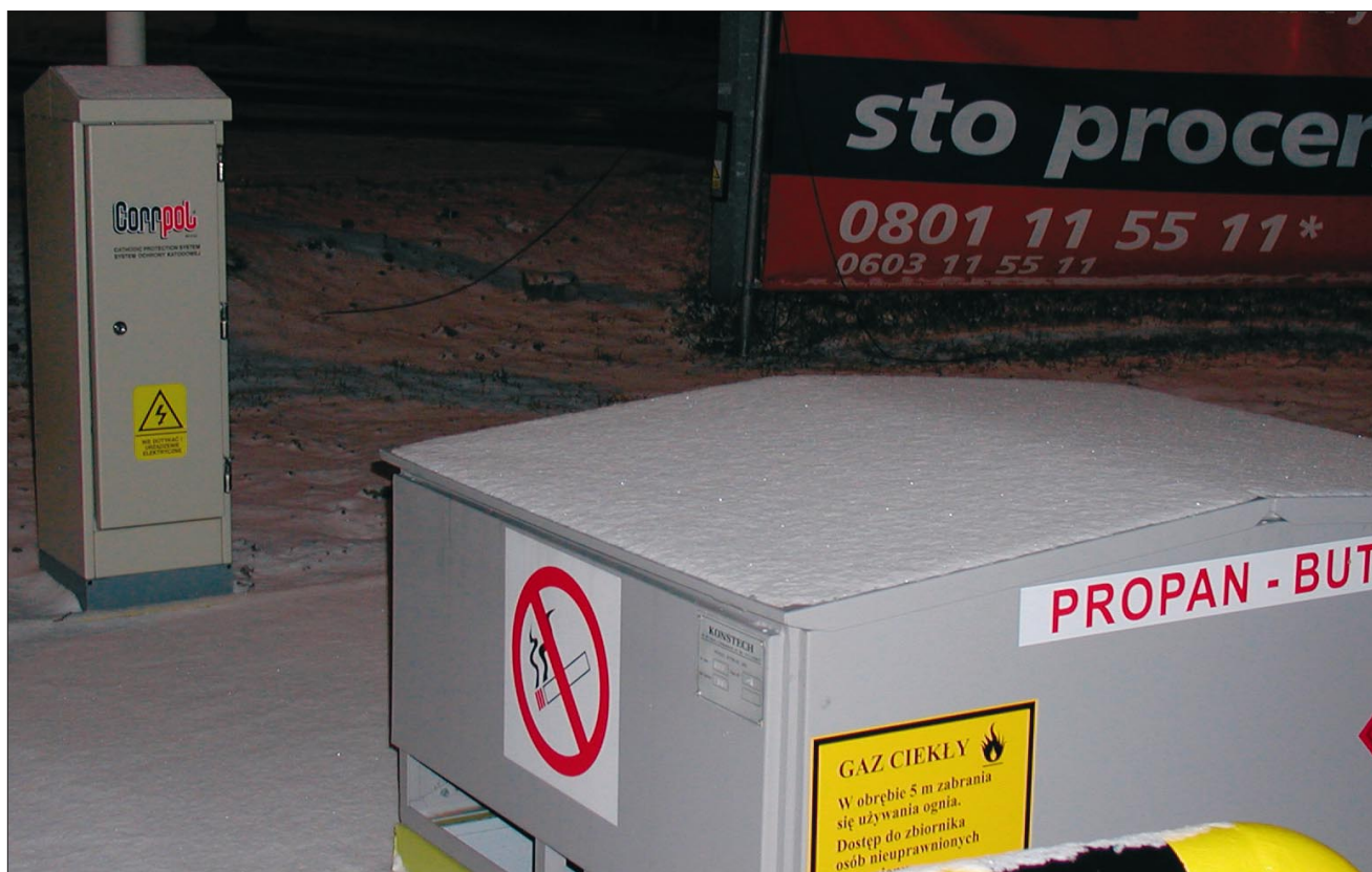
Na powierzchni ziemi widoczne są jedynie niewielkie szafki z elementami kontrolnymi instalacji ochrony katodowej (w głębi).
