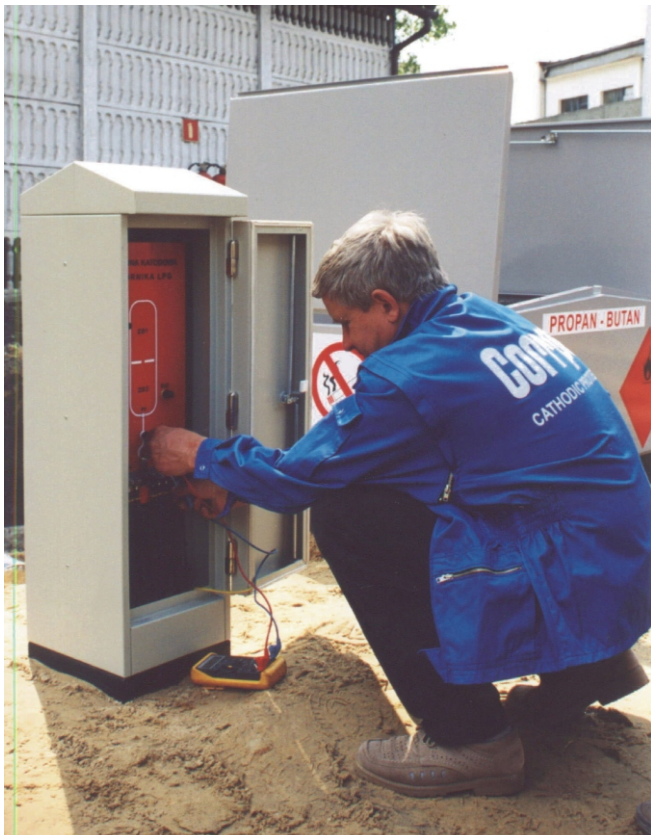
Po wykonaniu prac ziemnych jedynym zewnętrznym elementem jest szafka ochrony katodowej, w której znajdują się wszystkie połączenia instalacji.
