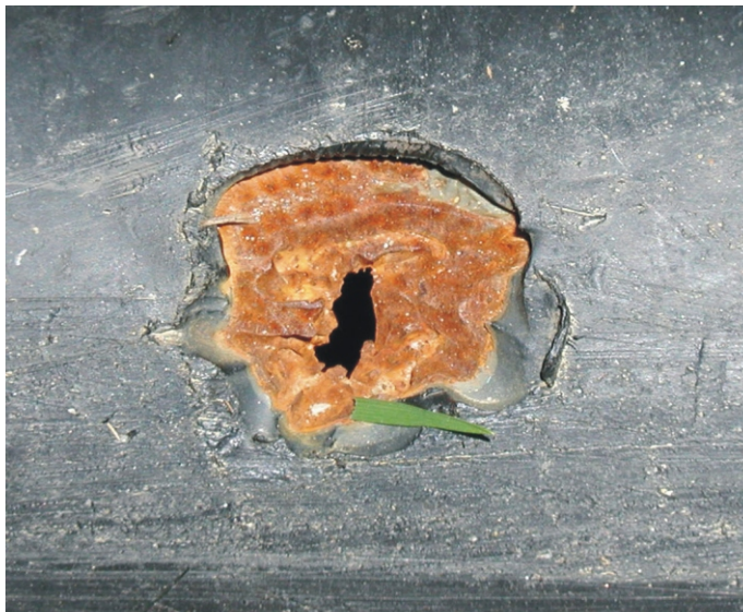
Lokalne uszkodzenie korozyjne ścianki stalowej w niewielkim defekcie bardzo dobrej powłoki ochronnej.
