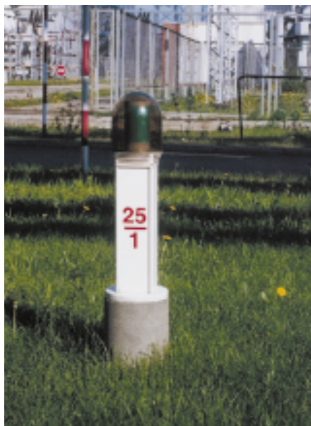
Wygląd typowego słupka kontrolno-pomiarowego z tworzywa sztucznego
